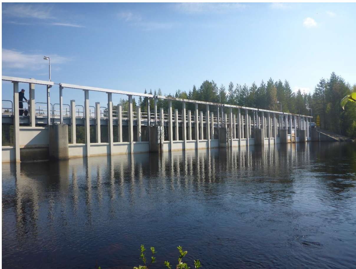
Figur 60. Lomforsdammen under sommarhalvåret med luckdrift. Foto taget uppströms dammen. Foto: Åsa Widén
