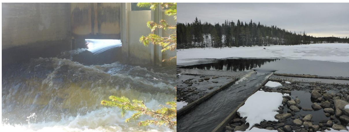
Figur 61. Vänster panel. Fiskväg under sommarhalvåret som justeras med en manuell lucka. Höger panel. Vinter. Flöde genom betongrännor med öppna luckor. Foto: Åsa Widén
