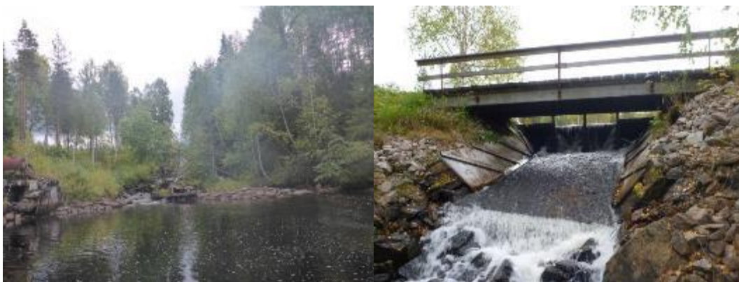
Figur 72. Vänster: utloppet med raserad kvam (partiellt vandringshinder). Höger: damm vid inlopp (definitivt vandringshinder)
